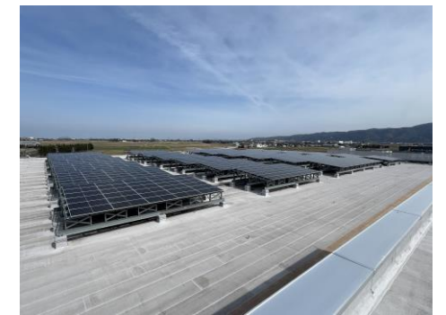
川北工場(屋上) 太陽光発電設備
